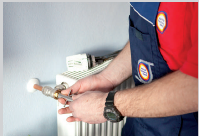
Eine optimal eingestellte Heizungsanlage führt nur so viel Wasser in den Heizkörper, wie benötigt wird.
